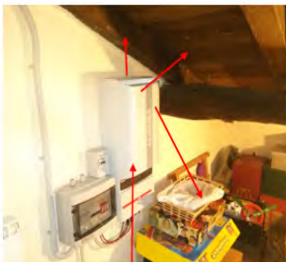
Vicinanza dell'inverter a copertura combustibile
